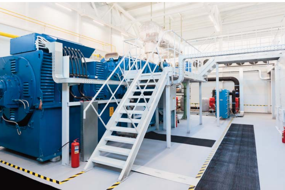
Газопоршневой энергоблок TCG 2032B V16 компании MWM
