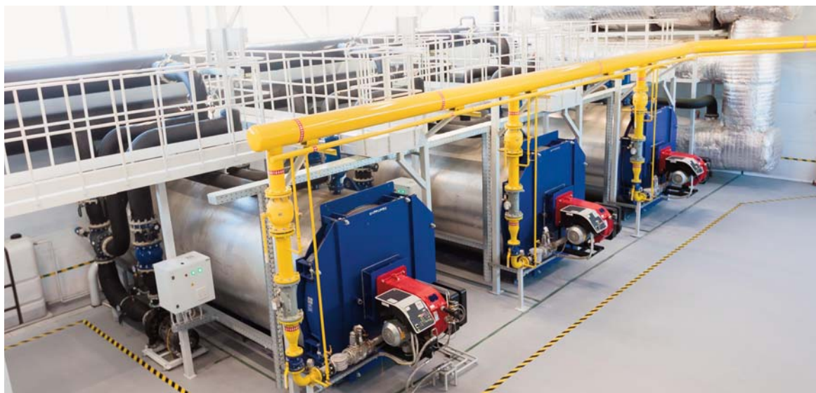
☉ Котельный цех – три водогрейных котла TT100 производства компании «Энтророс Термотехник»
