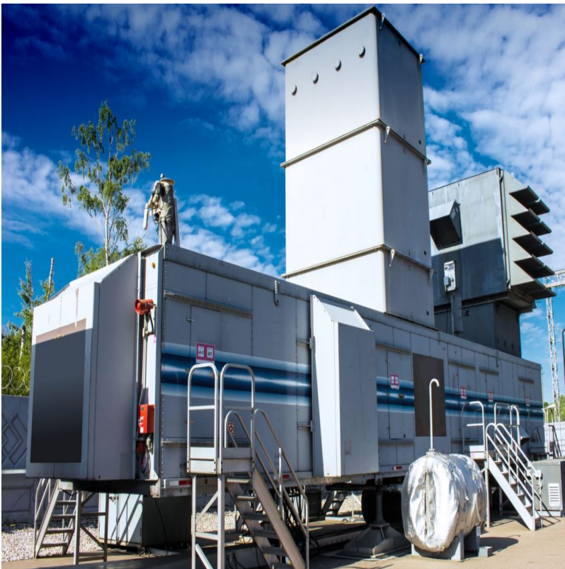
Mobile gas-turbine power plant
