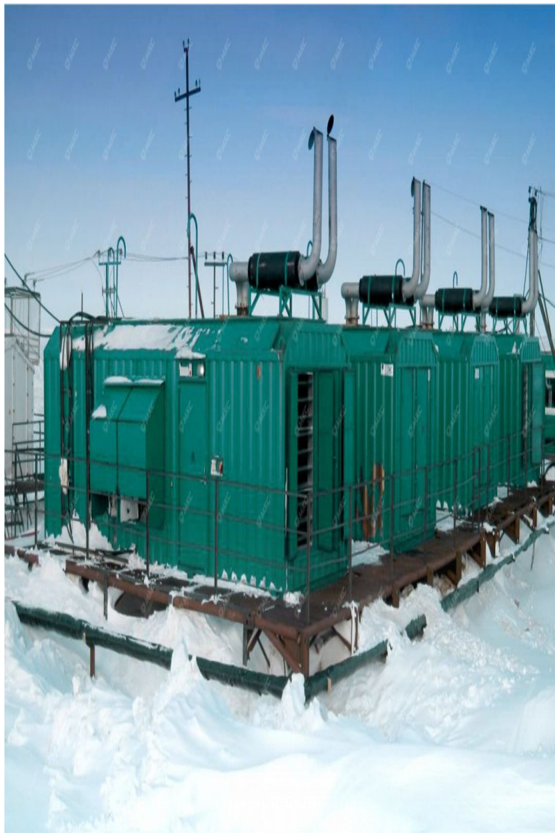
фото дизельной электростанции
