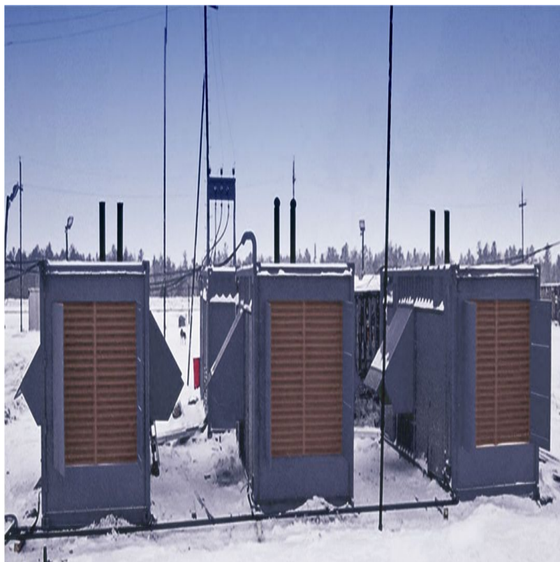
фото энергокомплексов на базе дизельных электростанций
