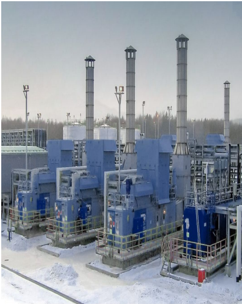
Стационарная газотурбинная электростанция
