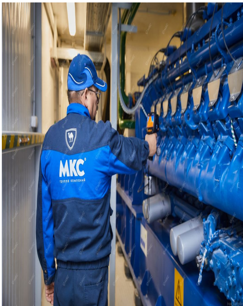
сотрудник группы компаний "МКС" измеряет температуру линии отводящих газов двигателя MWM при помощи тепловизора
