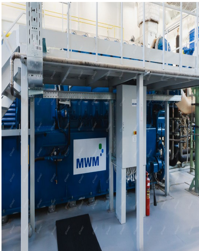
Энергоцентр для "НЛМК-Урал"
