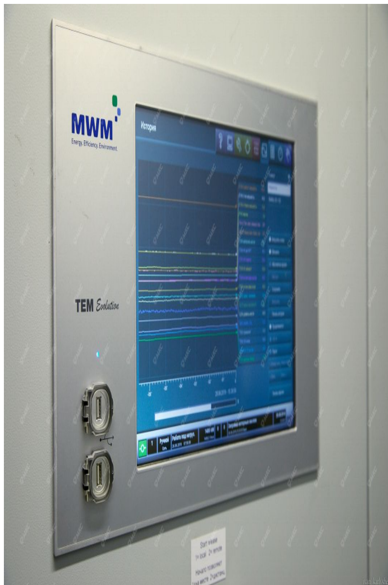
Система управления когенерационной установкой на объекте
