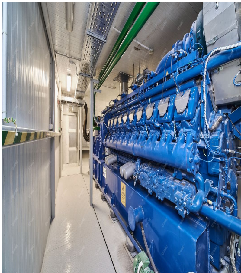
Когенерационные установки (КГУ) на объекте
