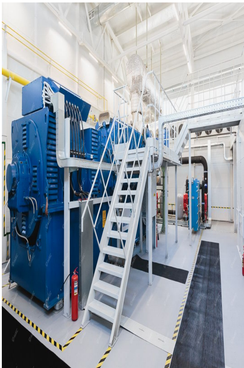
Когенерационная установка на объекте
