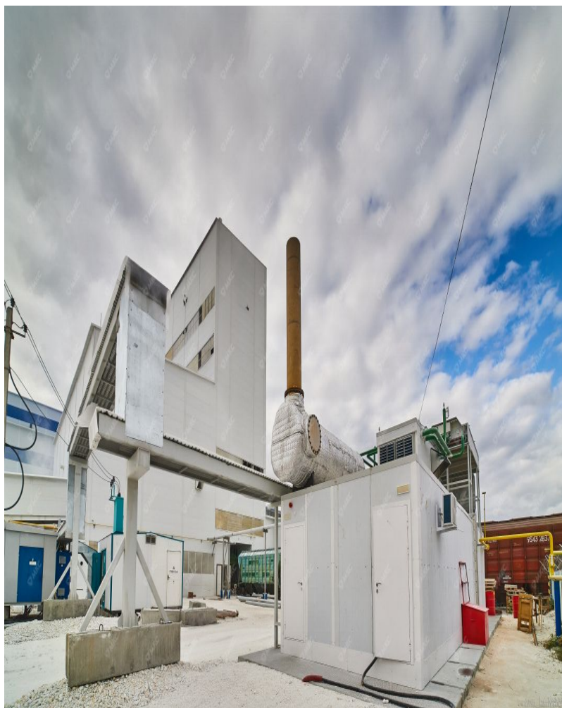
Мини-ТЭС производства Группы компаний «МКС» в составе предприятия по добыче и переработке природного камня
