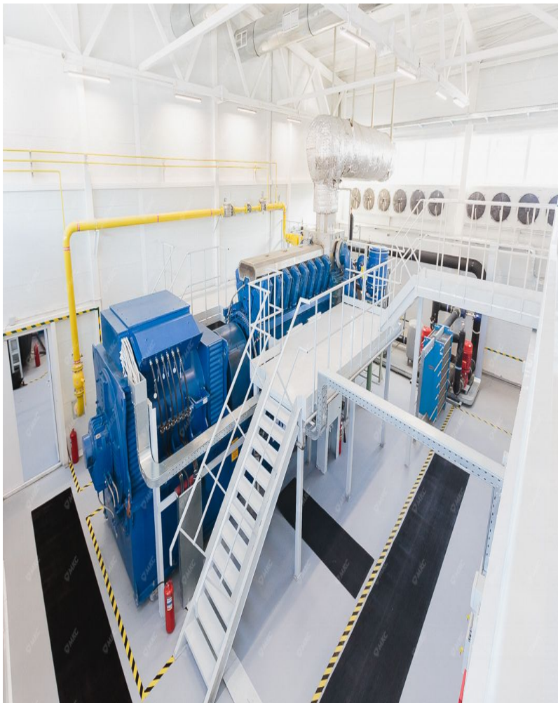
Когенерационная установка (КГУ) MWM на объекте
