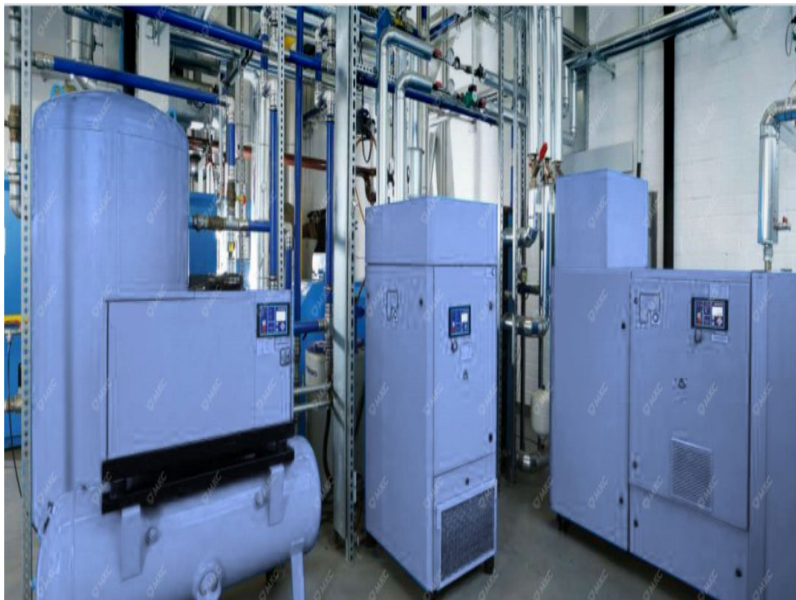
помещение компрессорной станции сжатого воздуха
