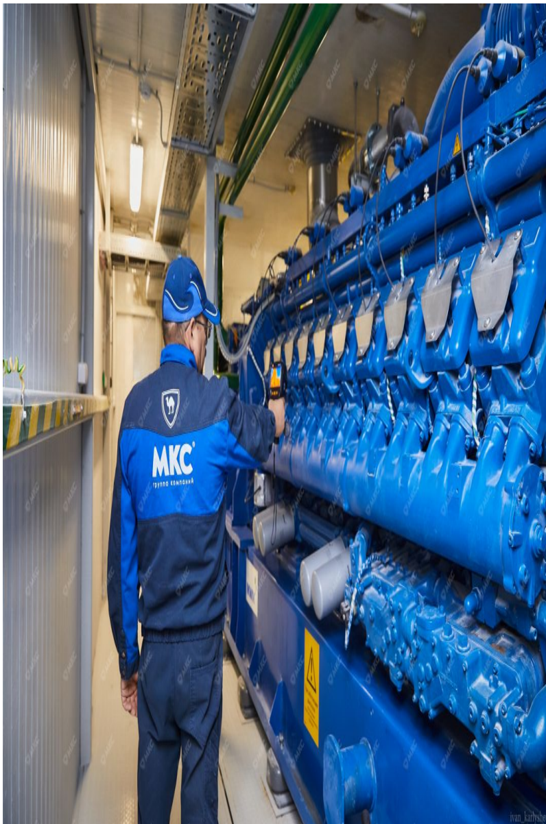
Газопоршневая установка марки MWM. Фото группы компаний МКС
