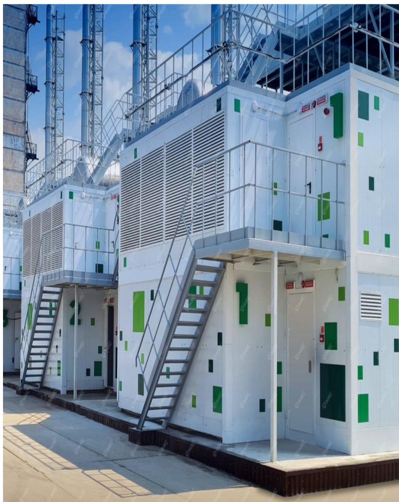
энергоцентр для завода НЛМК Ревда
